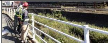
危険個所詳細 草木多い
